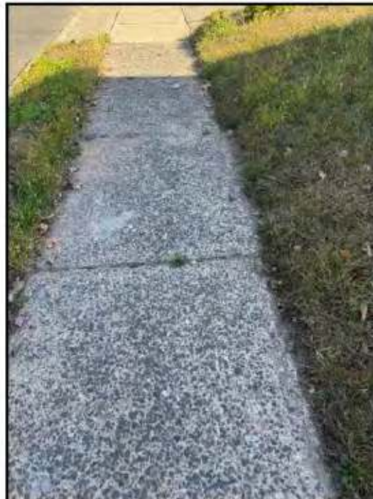
104. Uneven (trip hazard)
