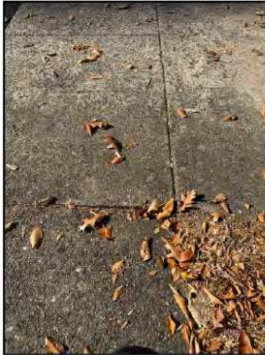
94. Uneven (trip hazard)
